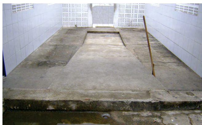
Rampas fora das normas técnicas da ABNT
