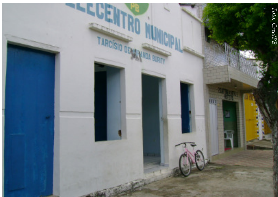
No Telecentro Municipal de Ingá: calçadas desniveladas e batentes dificultam o acesso de pessoas com mobilidade reduzida e impedem o exercício do direito de ir e vir de cadeirantes
