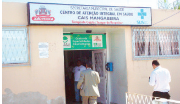
INFRAESTRUTURA - Prédios apresentam infiltrações e rachaduras
