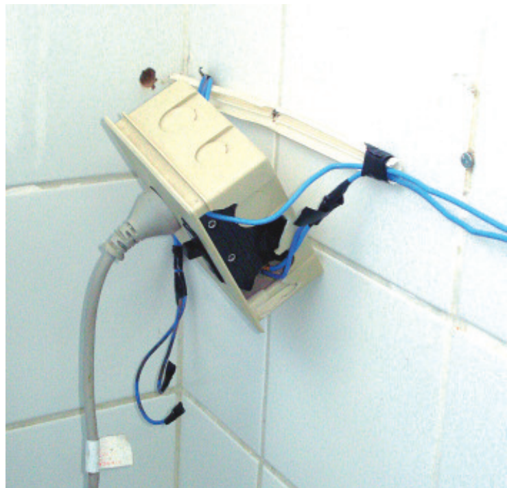
NO CAIS - Fiação exposta compromete segurança de pacientes
