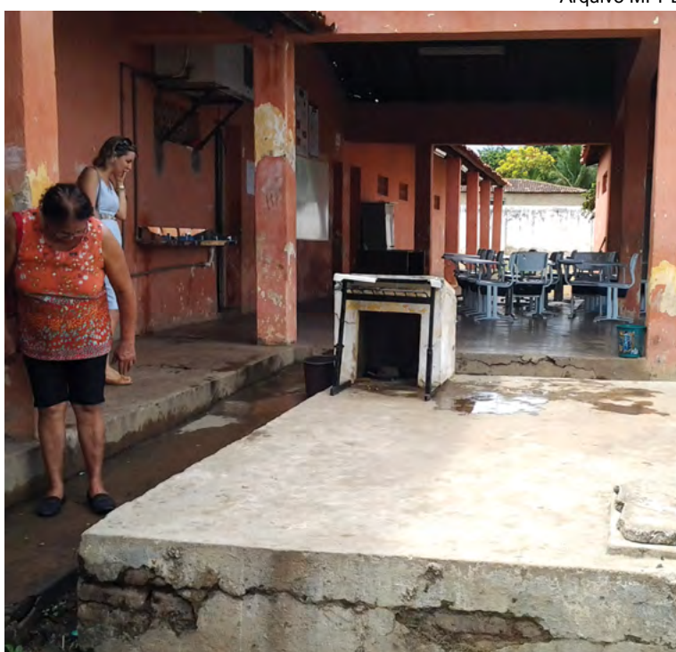
CATINGUEIRA - EE Inácio da Catingueira tem péssimas condições
