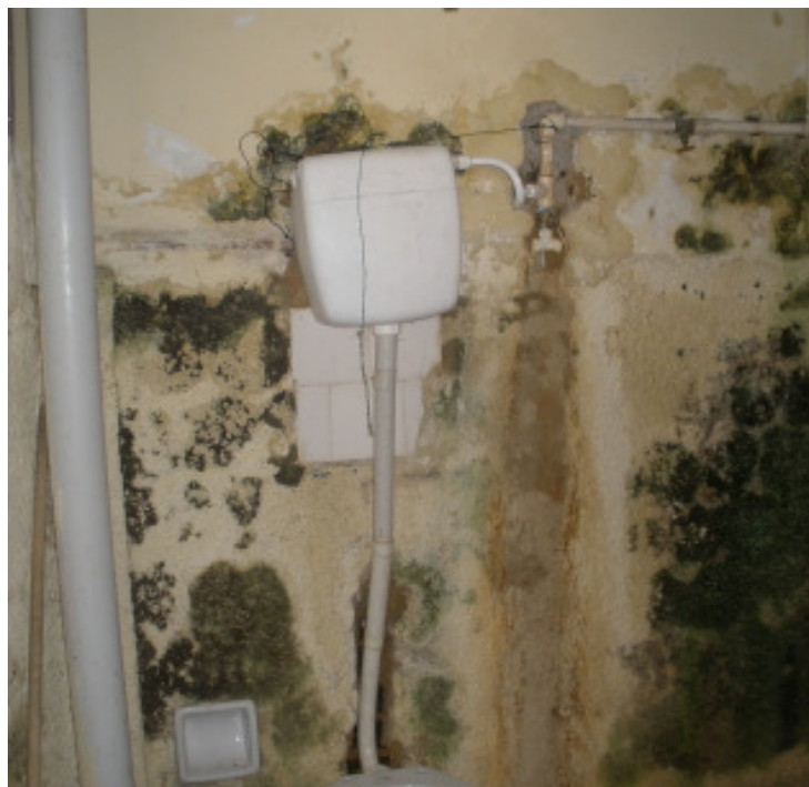
CASA DO ESTUDANTE - paredes mofadas e banheiros quebrados
