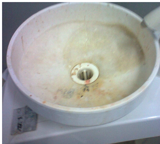
PRECÁRIO- Pias sem condições de funcionamento
