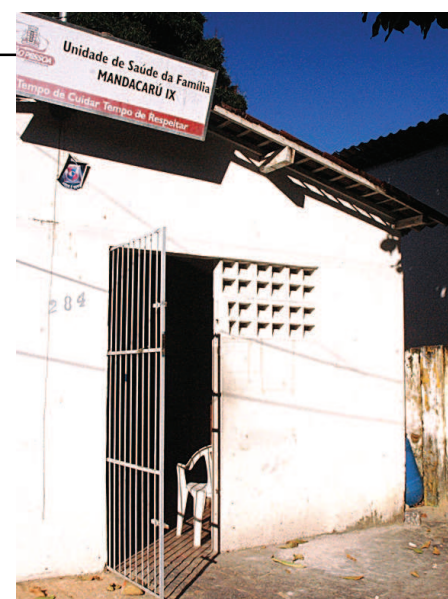
ESTRUTURA - Condições precárias
