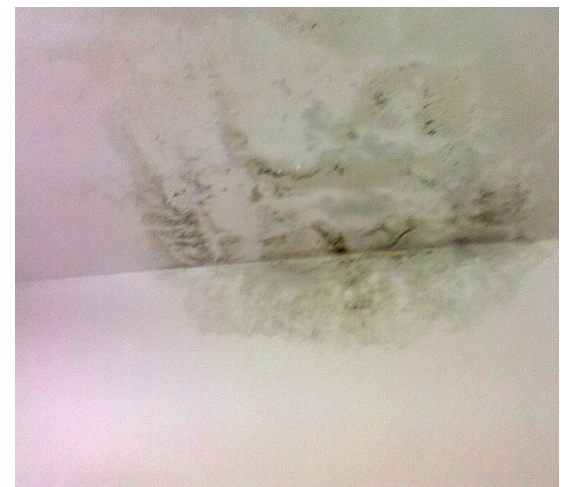
CONDIÇÕES - Paredes e tetos cheios de mofo
