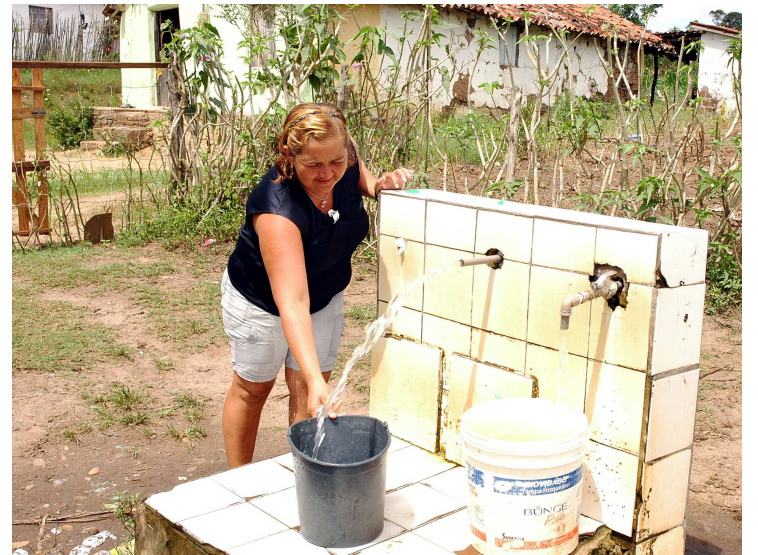
EM CRUZ DO ESPÍRITO SANTO - Moradores sofrem com a falta d'água
