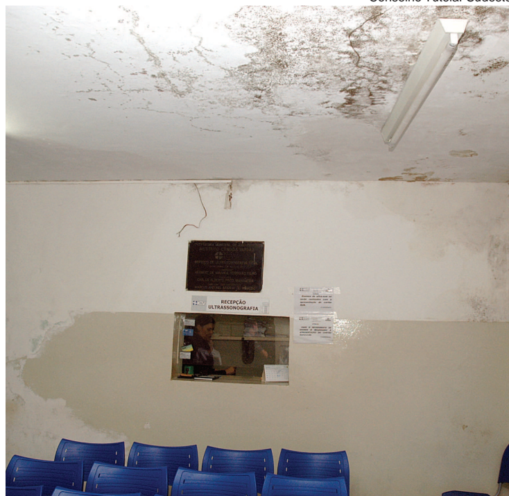
REFORMA - Sala de recepção da ultrassonografia do ICV apresenta infiltrações
