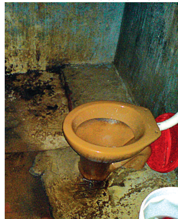
SEM HIGIENE - Banheiro da cela está quebrado
