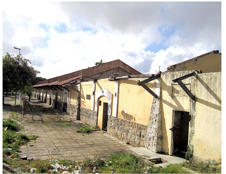
DEGRADAÇÃO - Prédio da Estação sofre os efeitos do tempo
