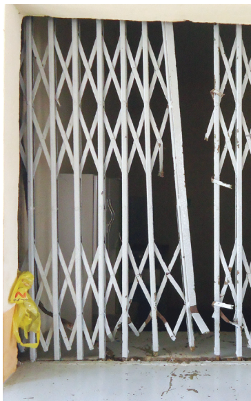
Porta de escola estava quebrada
