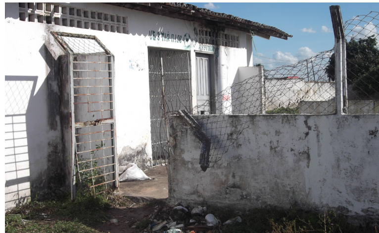
IRREGULAR - Patrimônio Público abandonado em Mamanguape
